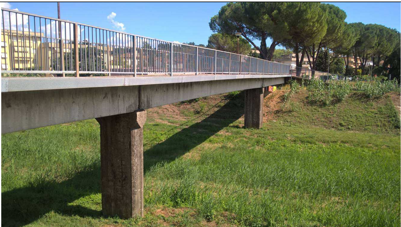
Fig.2 – Vista generale della passerella all'altezza della campata centrale che sormonta il corso d'acqua del torrente Agliena (lato di valle orientato verso ovest)
