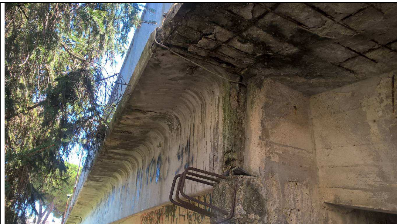
Fig. 8 – Vista di dettaglio di una mensola non interamente gettata sul lato di via Trento
