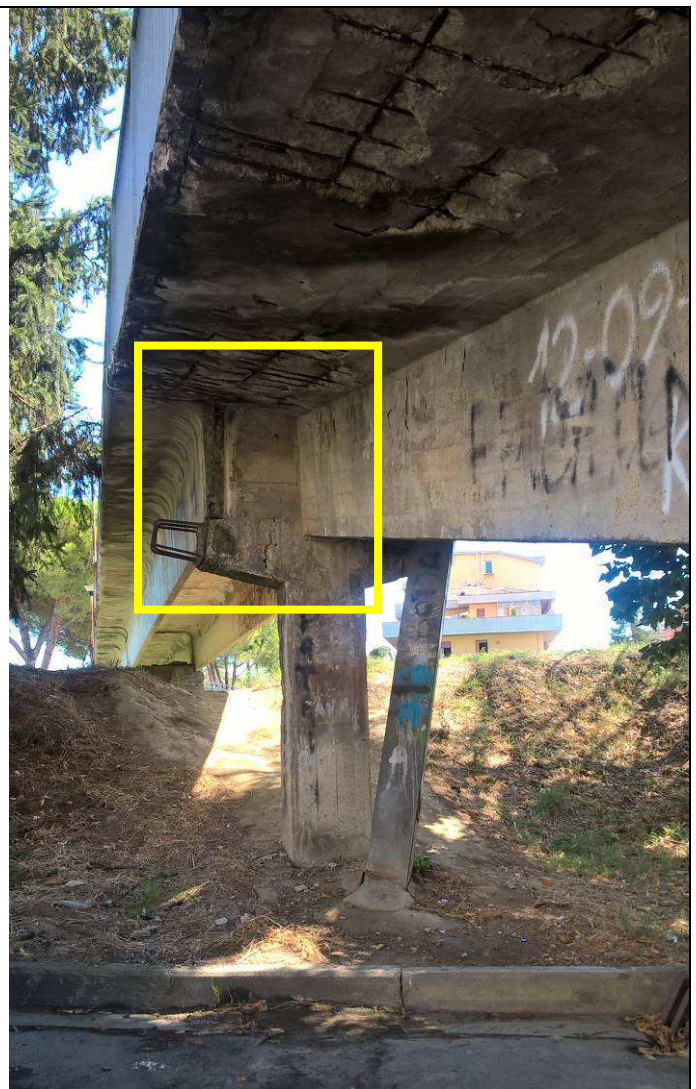
Fig.14 – Vista dell'innesto tra la pila n.4 e la trave della rampa su via Trento
