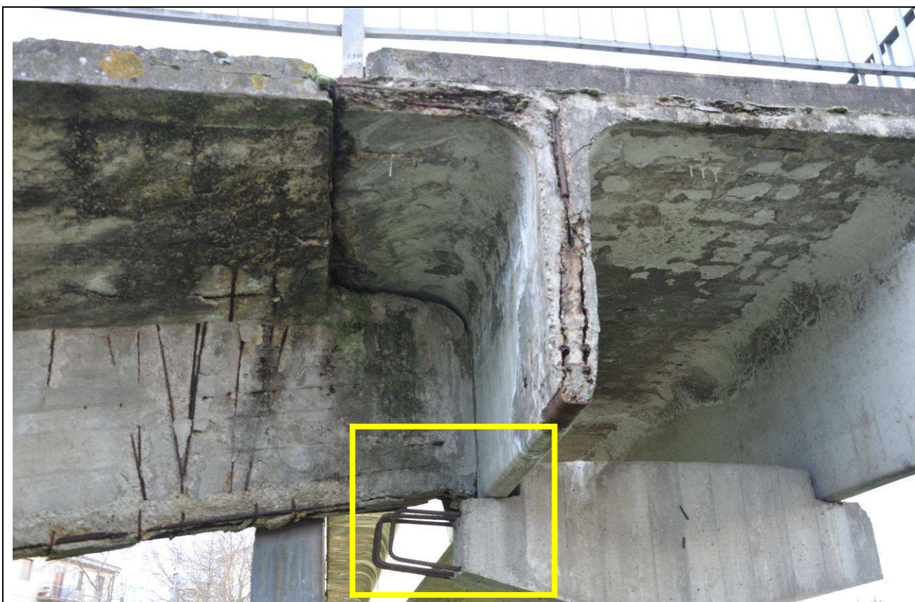
Fig.10 – Vista di dettaglio della trave della rampa sul lato di via Ciari che si protende (senza poggiare) sulla mensola ovest della pila, solo parzialmente gettata ed interessata da staffe d'armatura sporgenti
