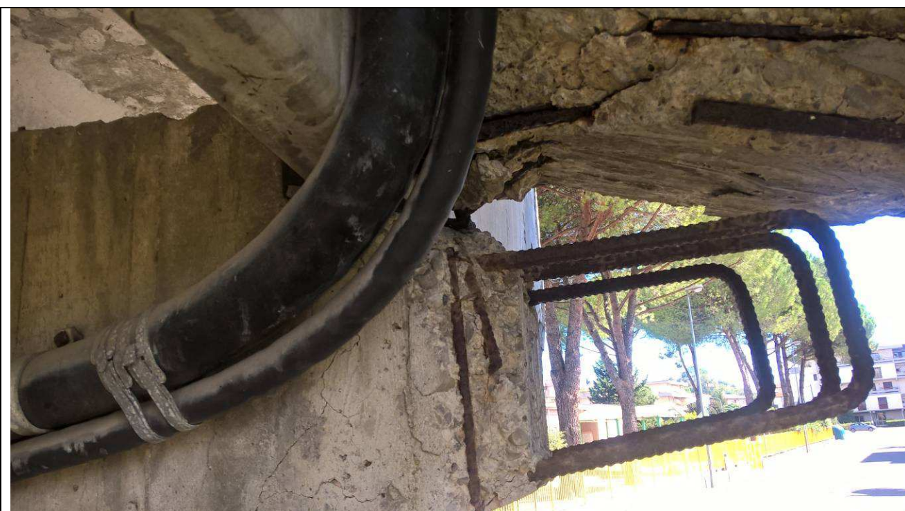
Fig. 9 – Vista di dettaglio di una mensola non interamente gettata sul lato di via Ciari
