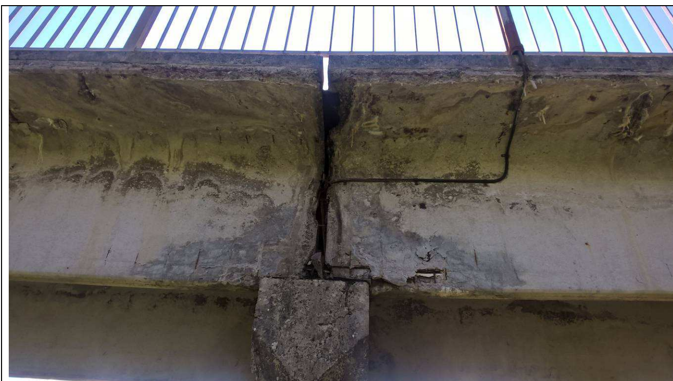
Fig. 7 – Vista del fianco delle travi precomprese all'appoggio sulla pila in alveo lato via Trento (si notano le staffe affioranti per effetto dell'espulsione del copriferro)
