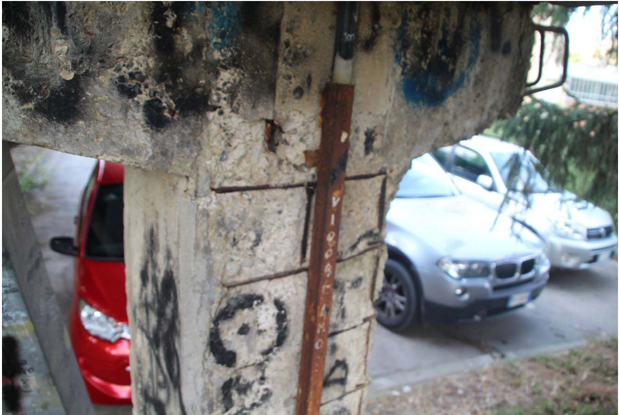
Figura 13 - Dettaglio della canaletta di adduzione dell'impianto elettrico addossata alla spalla in c.a. sul lato nord
