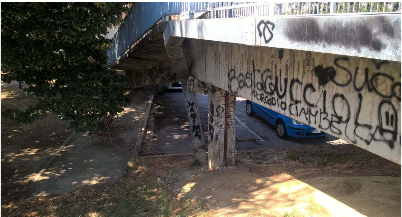
Figura 7 - Dettaglio dell'estremità della canaletta porta impianti sul lato di via Trento
