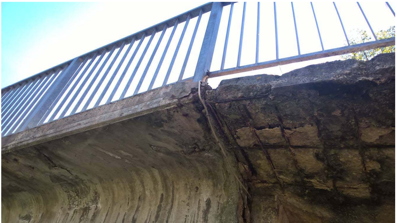
Figura 16 - Dettaglio del cavo dell'impianto di messa a terra collegato alla balaustra metallica sul lato di via Trento
