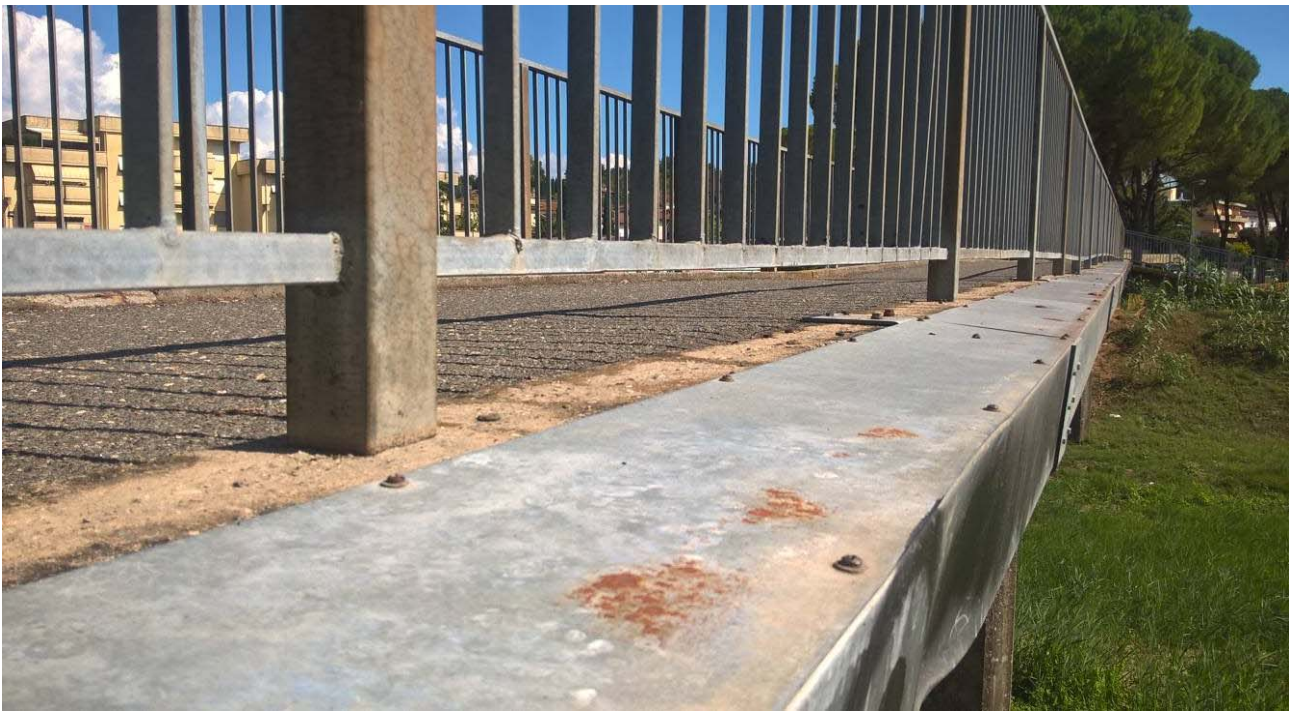
Figura 6 - Vista ravvicinata della canaletta porta impianti posta in affiancamento dell'impalcato sul lato di valle
