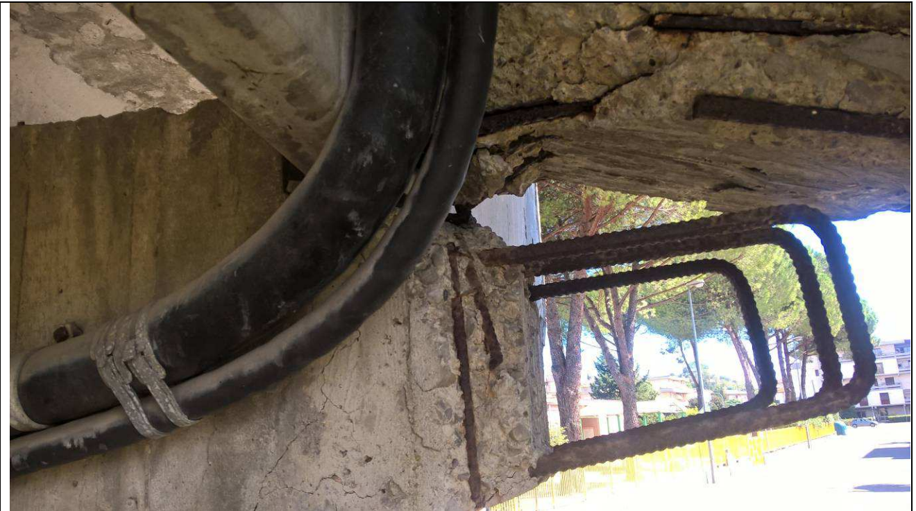
Fig. 6 – Vista di dettaglio di una mensola non interamente gettata sul lato di via Ciari (mancato collegamento con la trave della rampa, visibile nella parte superiore)
