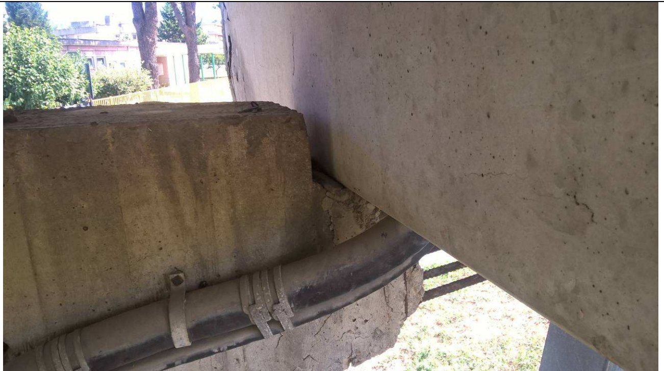
Fig. 36 – Dettaglio dell'appoggio di una nervatura della trave in c.a.p. sulla spalla sud (si nota in dettaglio il fascio di cavi che sale verso la canaletta porta impianti posta lungo il fianco dell'impalcato)
