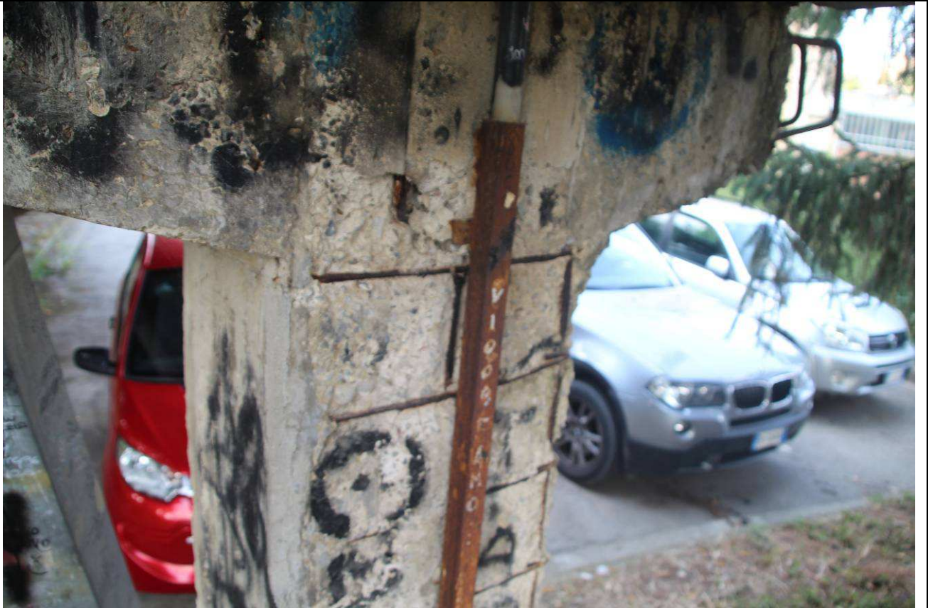
Fig. 37 – Dettaglio della canaletta di adduzione dell'impianto elettrico addossata alla spalla in c.a. sul lato nord
