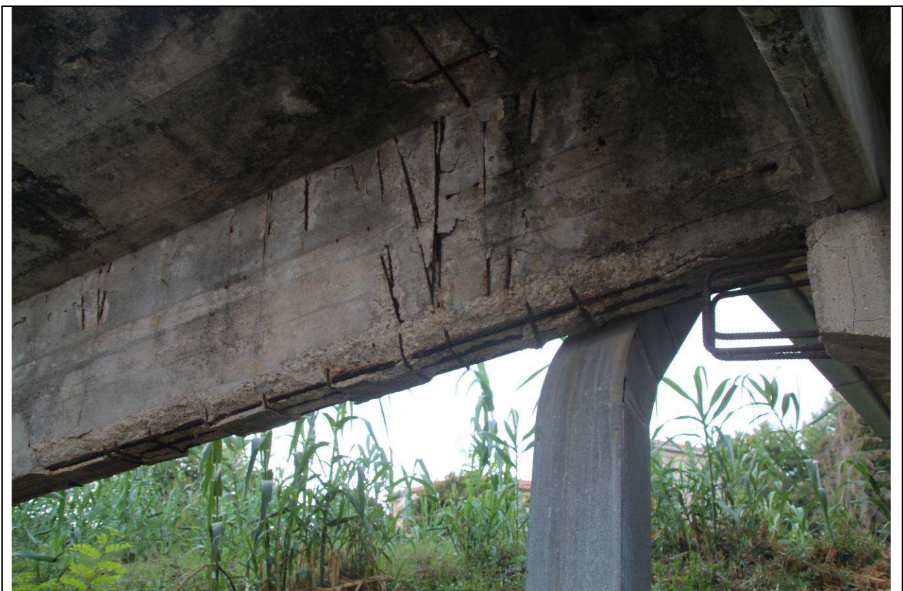
Fig. 44 – Dettaglio del degrado del calcestruzzo all'intradosso e sul fianco della trave della rampa lato via Ciari
