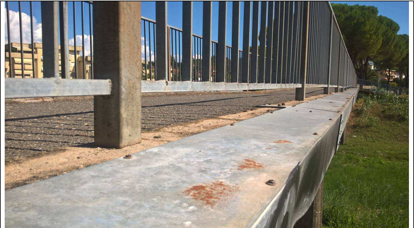
Fig. 30 – Vista ravvicinata della canaletta porta impianti posta in affiancamento dell'impalcato sul lato di valle
