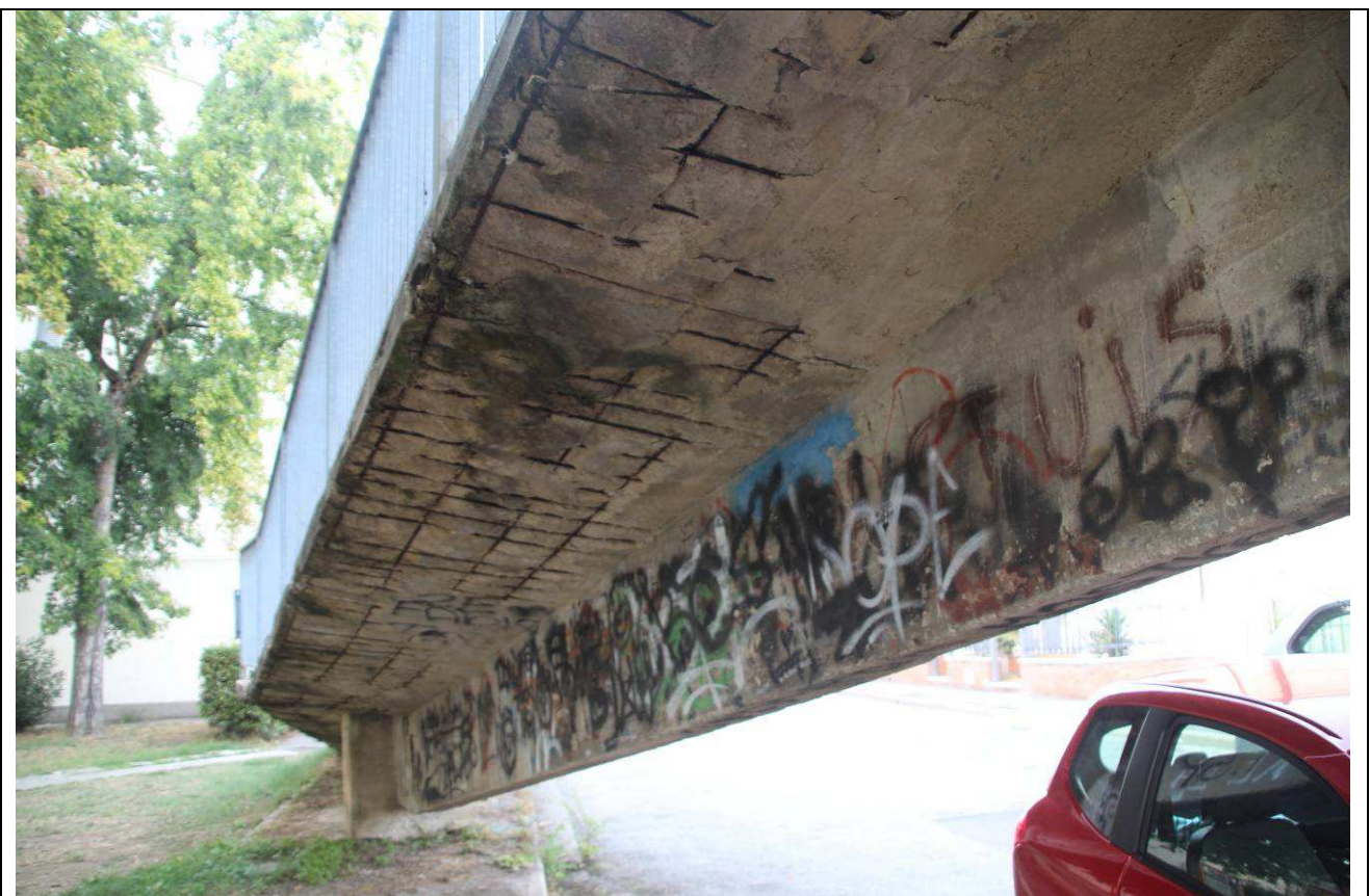
Fig. 42 – Vista del degrado del calcestruzzo all'intradosso della mensola sul fianco ovest della rampa (lato via Trento)
