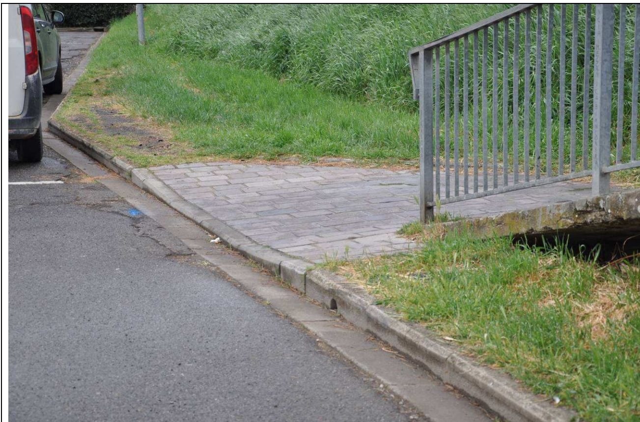
Fig. 21 – Dettaglio della pavimentazione attuale alla base della rampa su via B. Ciari
