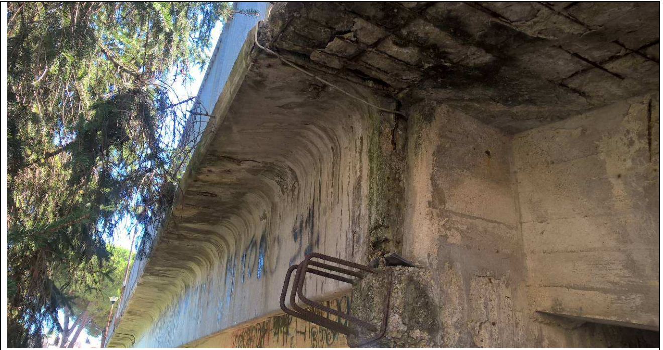
Fig. 15 – Vista in dettaglio di una mensola non interamente gettata sulla spalla lato via Trento
