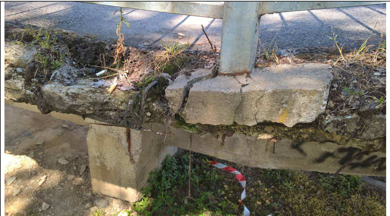
Fig. 52 – Particolare della rottura del cordolo di bordo sul lato ovest della rampa lato via Trento (l'ancoraggio del montante della balaustra appare del tutto compromesso)
