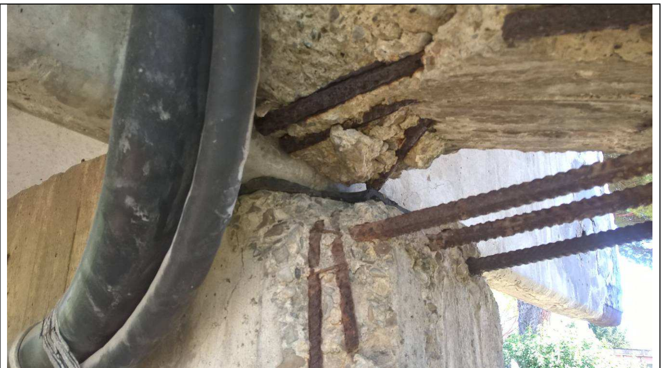
Fig. 7 – Dettaglio della mensola tra la spalla sud e la trave della rampa su via B. Ciari, in cui si nota la mancanza del collegamento tra le due parti della struttura
