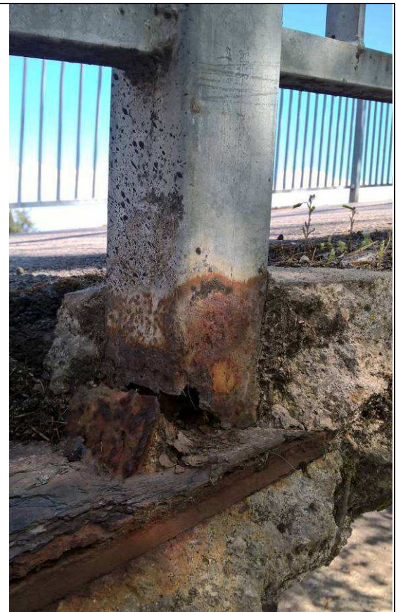
Fig. 54 – Dettaglio della corrosione alla base di un montante della balaustra (zona rampa lato via Trento)
