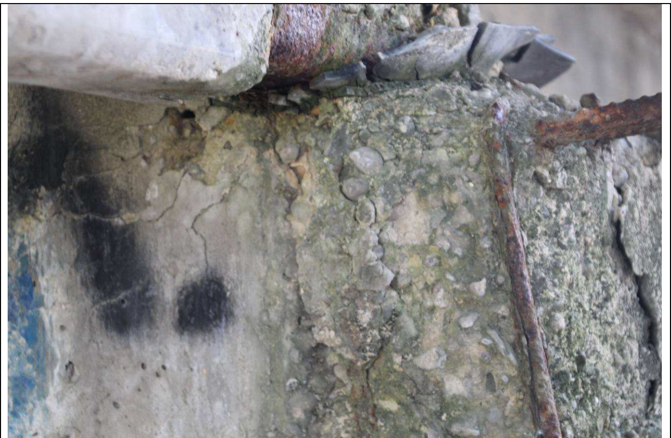
Fig. 46 – Dettaglio della rottura di una piastrina di neoprene all'appoggio di una trave in c.a.p. (è ben visibile anche lo stato di profondo degrado in cui versa la struttura in calcestruzzo gettato in opera della mensola di sostegno)
