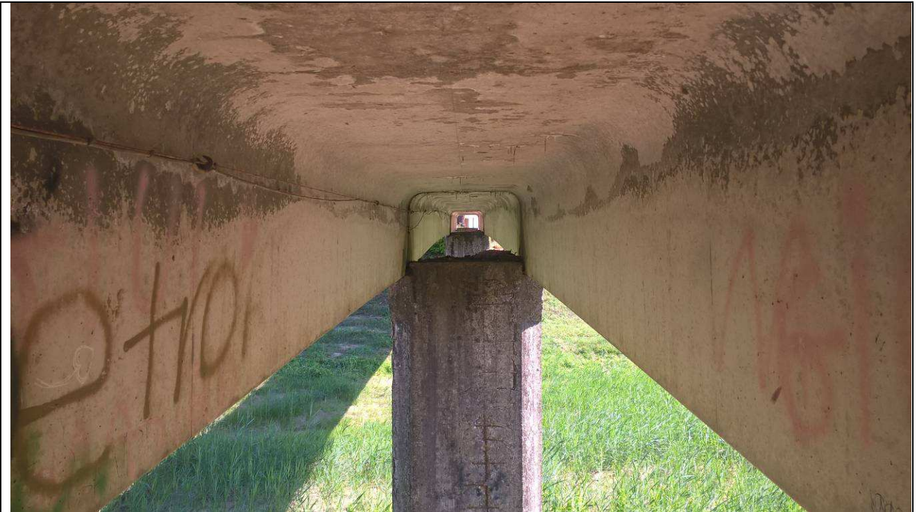
Fig. 11 – Vista della parte interna tra le nervature del tegolo precompresso, con dettaglio del baggio di contrasto in testa alla pila gettata in opera (pila in alveo lato via Trento)
