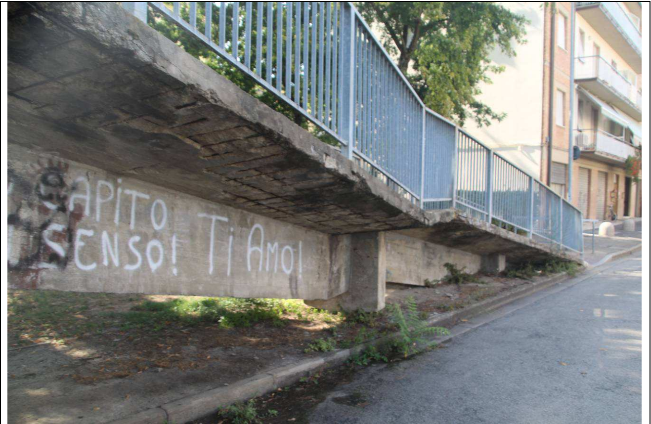
Fig. 41 – Vista del degrado del calcestruzzo all'intradosso della mensola sul fianco est della rampa (lato via Trento)
