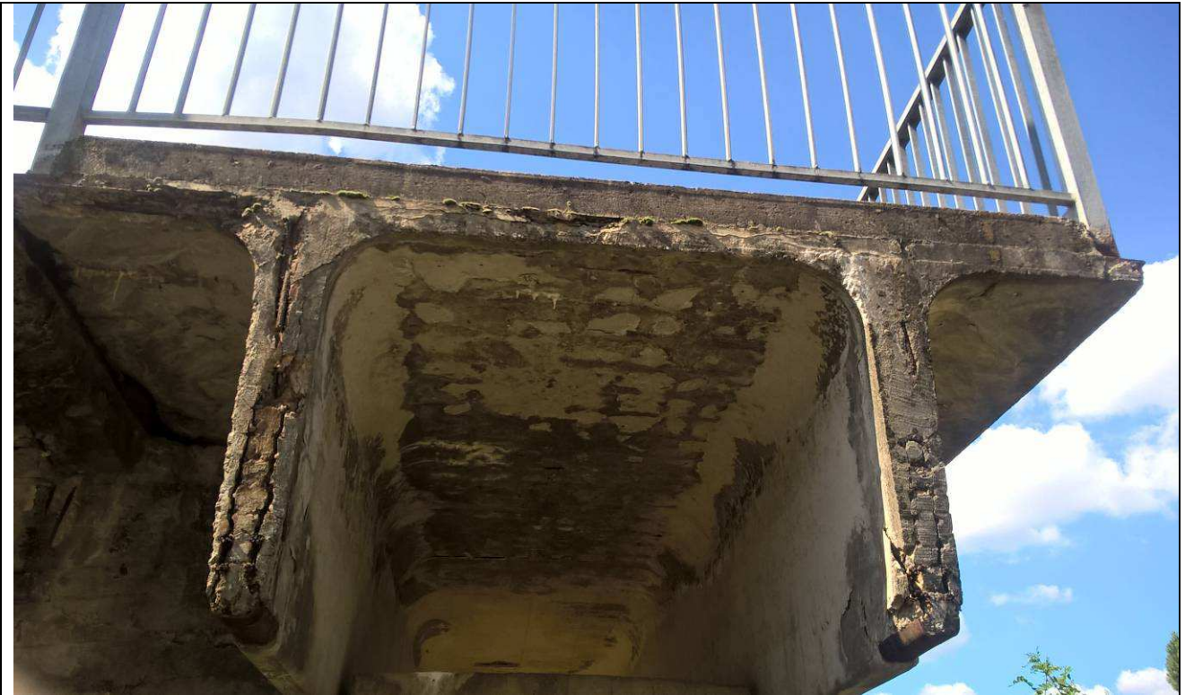
Fig. 4 – Vista della testa della trave precompressa aggettante verso via Ciari, con le teste dei trefoli di acciaio armonico in vista nelle nervature (sezione di ancoraggio dei trefoli soggette a vistose disaggregazioni del getto di calcestruzzo)
