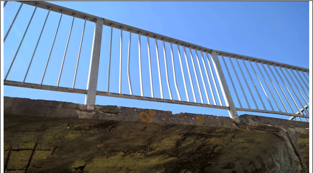
Fig. 57 – Vista del degrado del calcestruzzo all'intradosso della mensola sul fianco ovest della rampa (lato via Trento)
