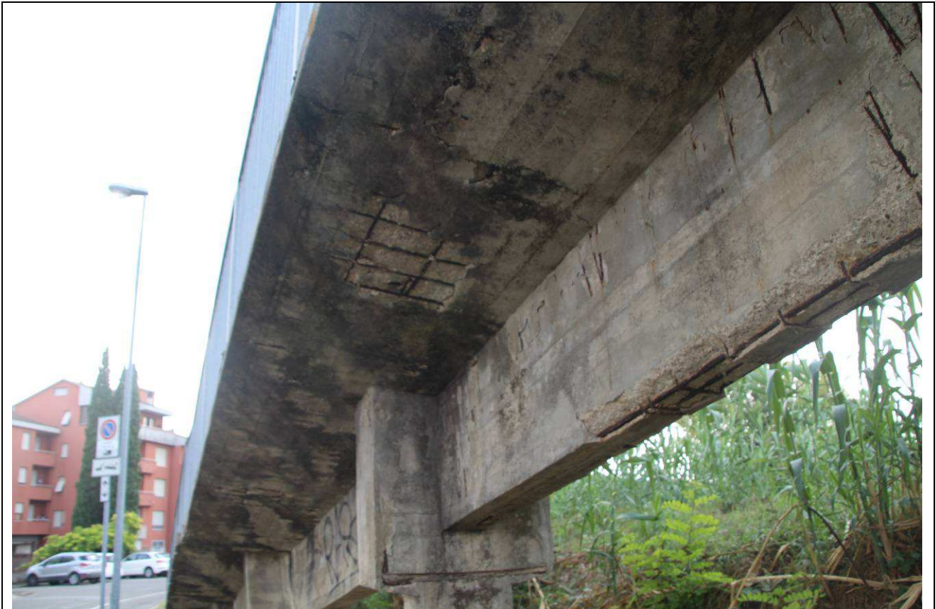
Fig. 43 – Vista del degrado del calcestruzzo all'intradosso della mensola e sulla trave della rampa lato via Ciari
