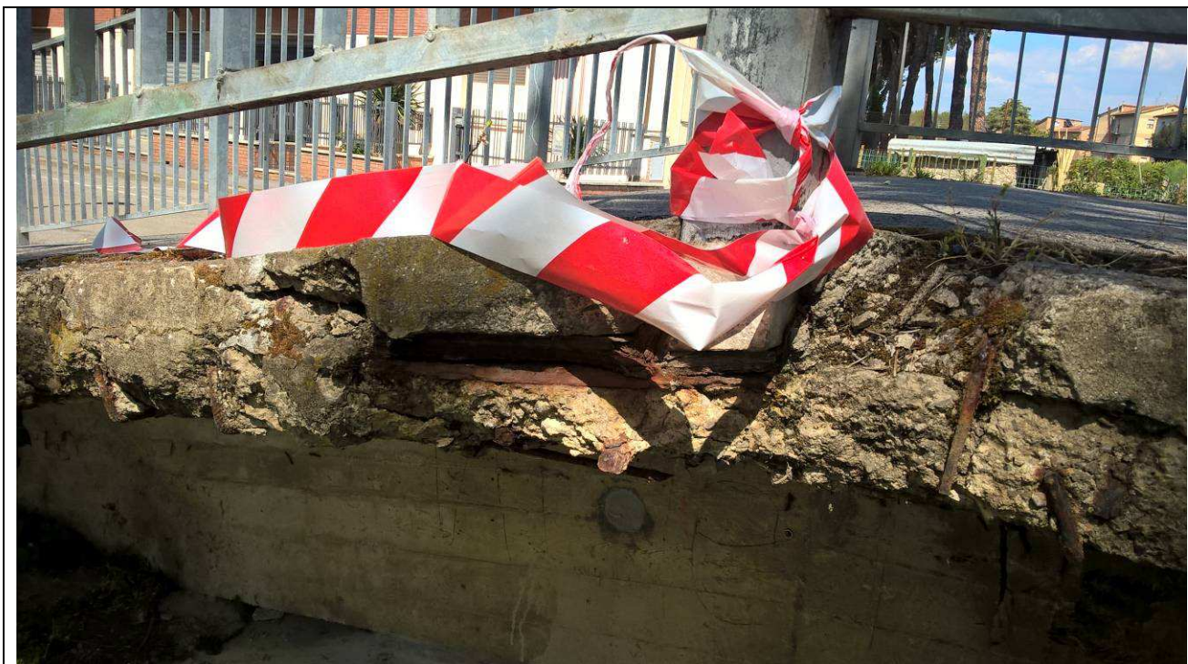
Fig. 55 – Vista del degrado del calcestruzzo all'intradosso della mensola sul fianco ovest della rampa (lato via Trento)
