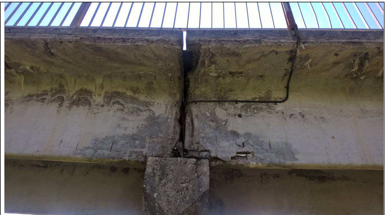
Fig. 12 – Vista del fianco delle travi precomprese all'appoggio sulla pila in alveo lato via Trento (si notano le staffe affioranti dalle travi per effetto dell'espulsione del copriferro e l'alimentazione elettrica che corre fino alla base del lampione installato sul fianco dell'impalcato)
