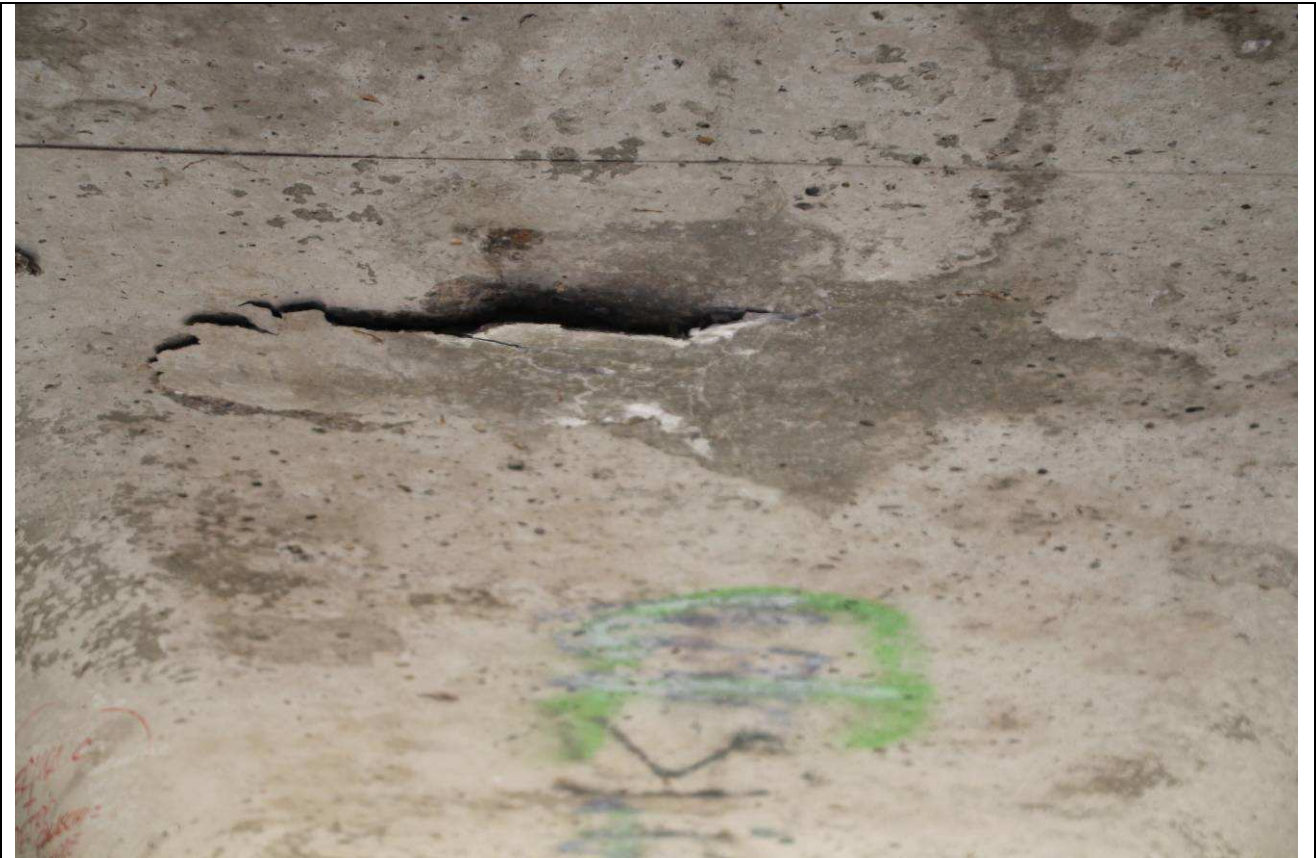
Fig. 45 – Particolare di una esfoliazione nella superficie in calcestruzzo all'intradosso di una delle travi prefabbricate
