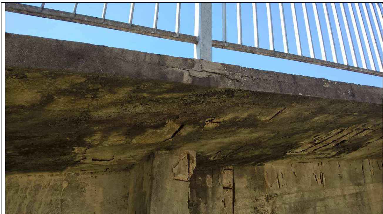
Fig. 56 – Particolare di una esfoliazione nella superficie in calcestruzzo all'intradosso di una delle travi prefabbricate
