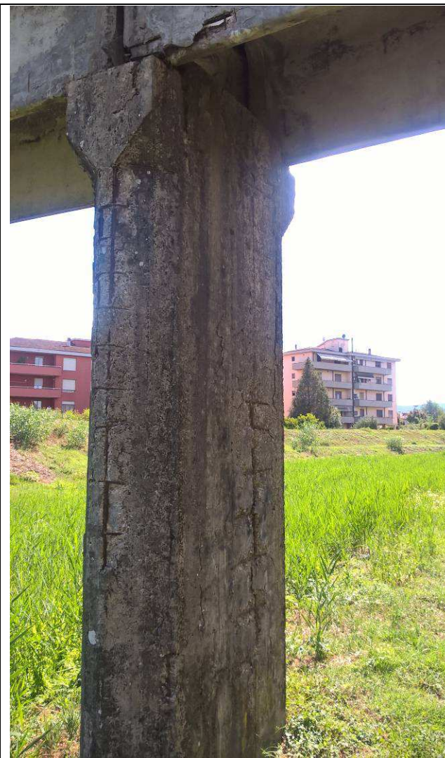
Fig. 16 – Vista generale della pila in alveo lato nord (armature affioranti su tutte le facce della struttura)
