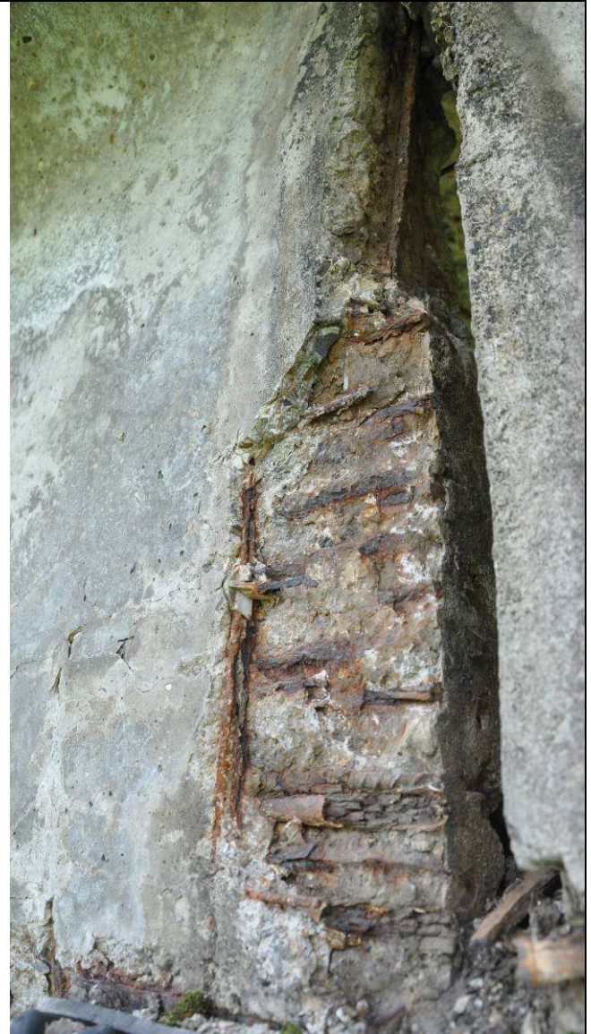
Fig. 48 – Vista di dettaglio del dissesto nella sezione di estremità di una trave in c.a.p. in corrispondenza dell'appoggio su una pila intermedia
